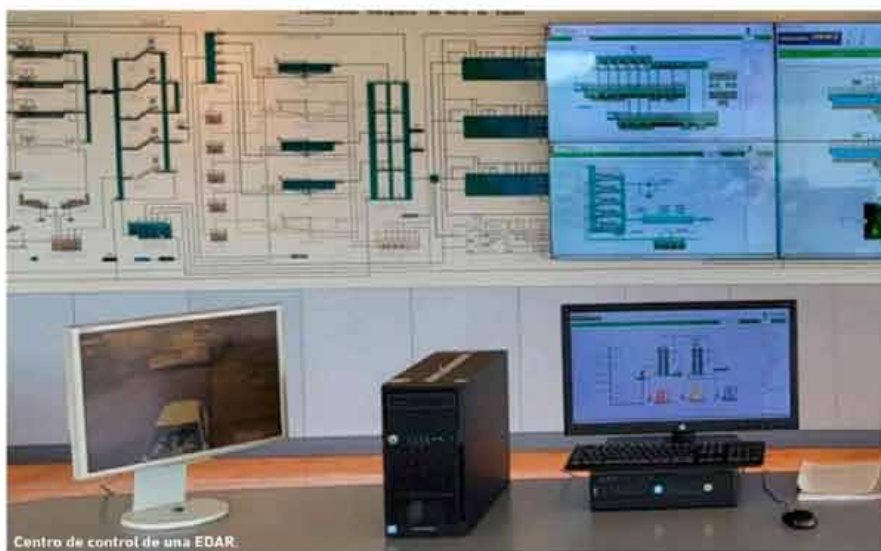
Centro de control de una EDAR.
